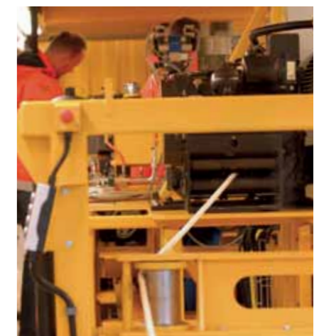
L'unité de manutention tire le rail dans le module d'usinage
